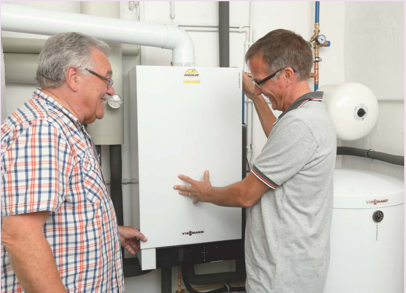
Die neue Heizungsanlage ist sparsam und läuft deutlich leiser als ihr 30 Jahre alter Vorgänger. Fotos: Zukunft ERDGAS e.V.
