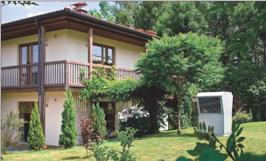
Luft-Wärmepumpe im Garten eines älteren Privathauses.
