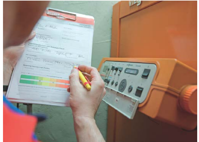
Lassen Sie alte Heizsysteme vom Fachmann überprüfen.
