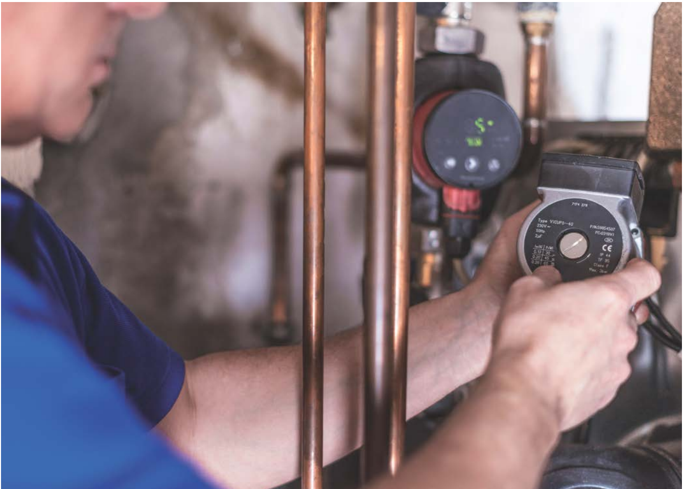
Hier wird untersucht, ob die Heizungspumpe elektronisch geregelt ist und im Verhältnis zum Gebäude richtig eingestellt oder überdimensioniert ist.
