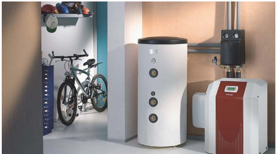
In einem Haus ist es ohne weiteres möglich, den gesamten Wärmeenergiebedarf über eine Sole/Wasser-Wärmepumpe abzudecken. Foto: Wärme+/Dimplex
